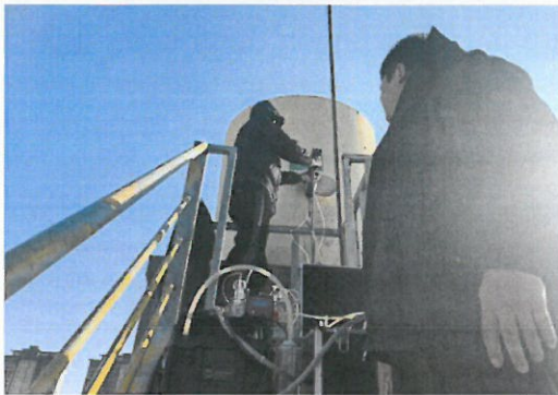
酸性废气排气筒 1#出口
