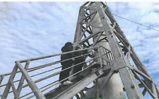
外延酸性废气排气筒出口
