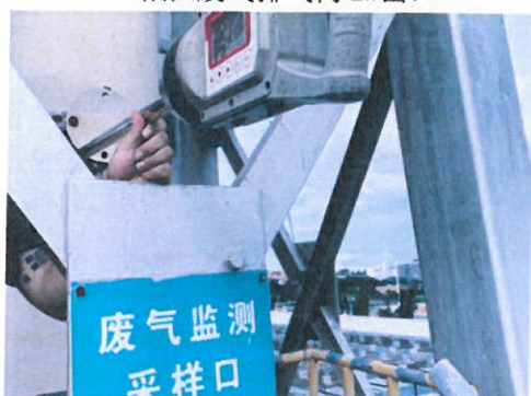
外延酸性废气排气筒出口
