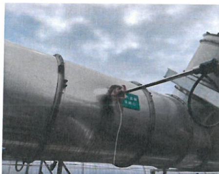
芯片车间有机废气排气筒 3#出口
