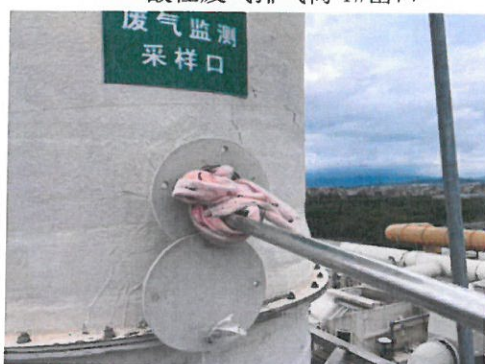
碱性废气排气筒 2#出口
