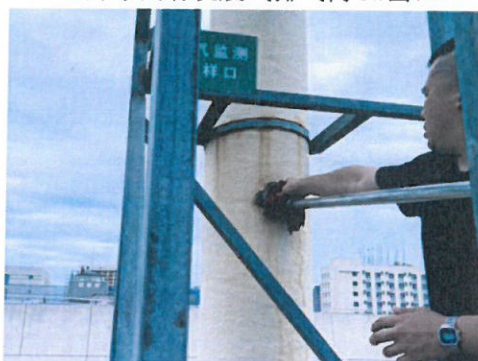
废水处理站排气筒出口
